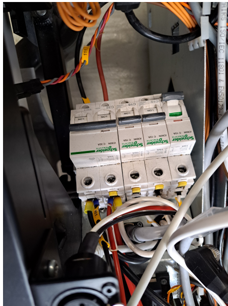
Figur 4.18. Sikring hvor spændingen fra dockingstationen og 230 volt opladeren går igennem inden den går ud til batteriet.
