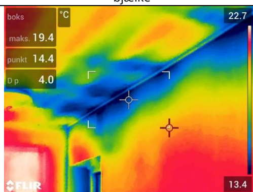
Flir 0568 – Overligger og gennemgående bjælke
