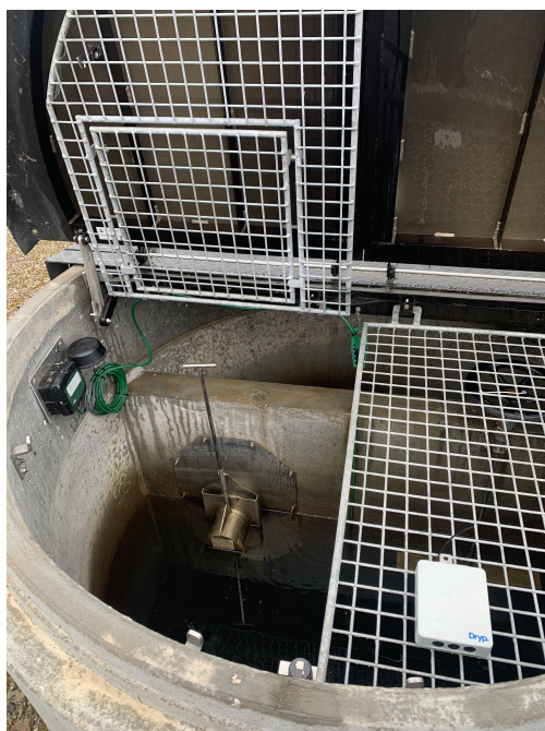
(a) Dryp radar placeret i udløbsbrønden til Frejlev Skolevej Bassin.
