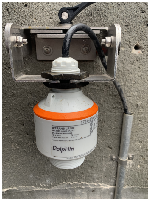
(b) SITRANS LR100 radar niveaumåler placeret i udløbsbrønden.
