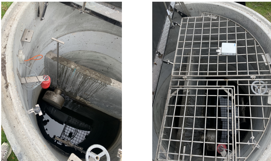
Figur 3.3. Vandstandsmåler til SRO (rød) og Dryp (sort) radar til niveaumåling i udløbsbrønden ved Aladdinvej Bassinet. Billeder taget 23/04/2025.
