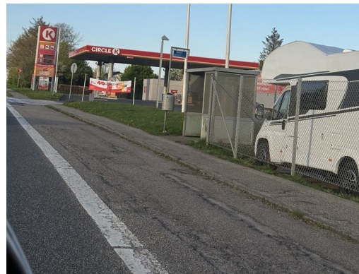
Figur 6.4. Belægningen på supercykelstien mellem Horsens og Hedensted, som er nedslidt og hullet. (Eget billede)
