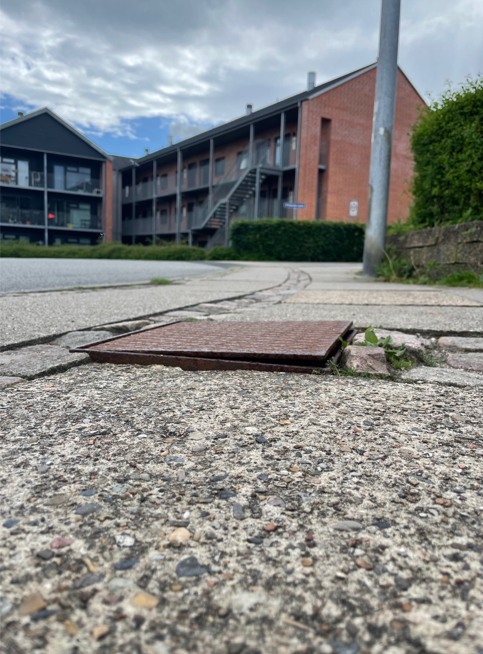
Figur 4.3. Forhøjet brønddæksel. (foto: Emma Juul Jensen)
