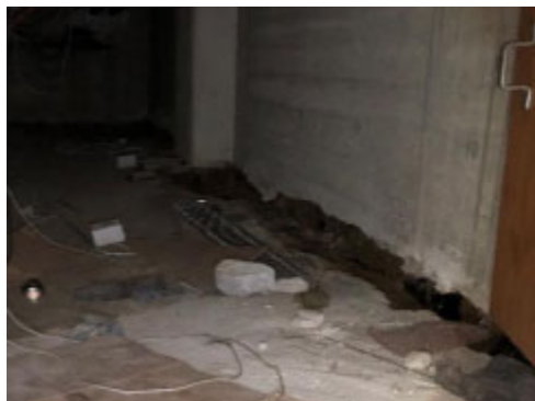
Figur 48- krybekælder med nedsunket terrændæk ved fundament/ydervæg ved varmekælder i bygning 6. (Kilde: tilstandsrapport)
