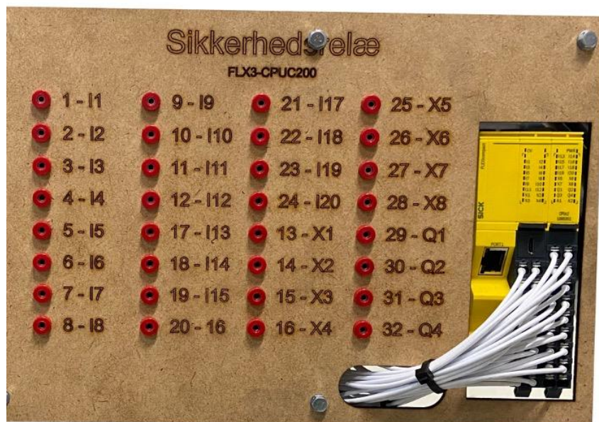
Figur 39 Billede af sikkerheds PLC'en på prototypen. Layoutet tager afsæt i at det for brugen skal være nemt og overskueligt at orientere sig, og tilslutte gear til enheden. Samtidig med at de mange PLC'ens kontrollamper skal være synlige.
