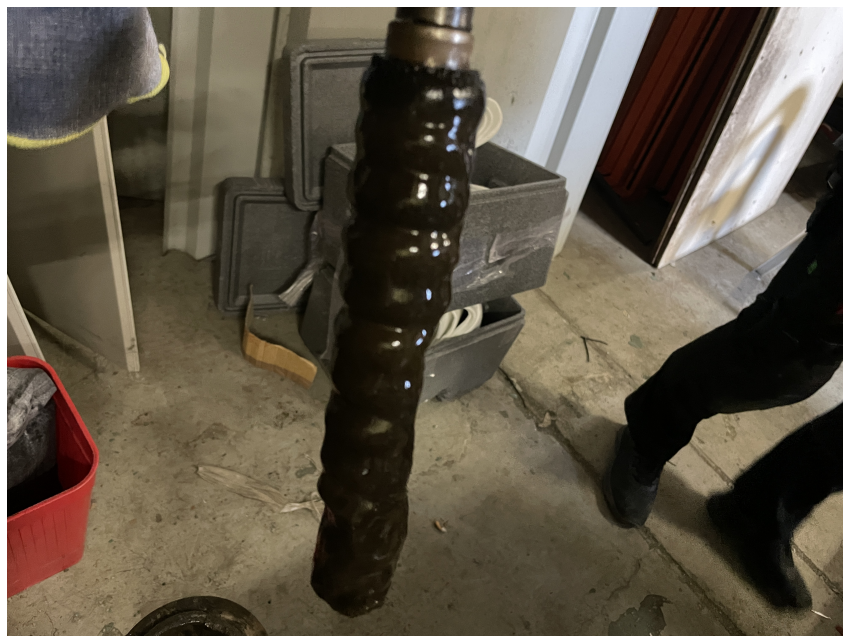
Figur 5.8. Magnetstang fra delstrømsfilter fyldt med metalaflejringer ved filterskifte
