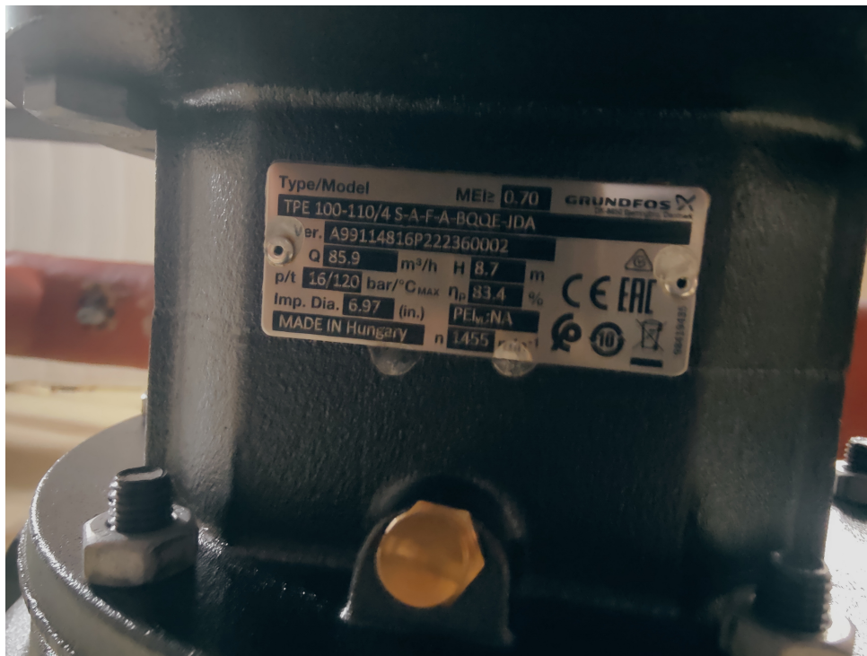
Figur 5.5. Mærkeplade tilhørende pumpe der betjener den store kreds
