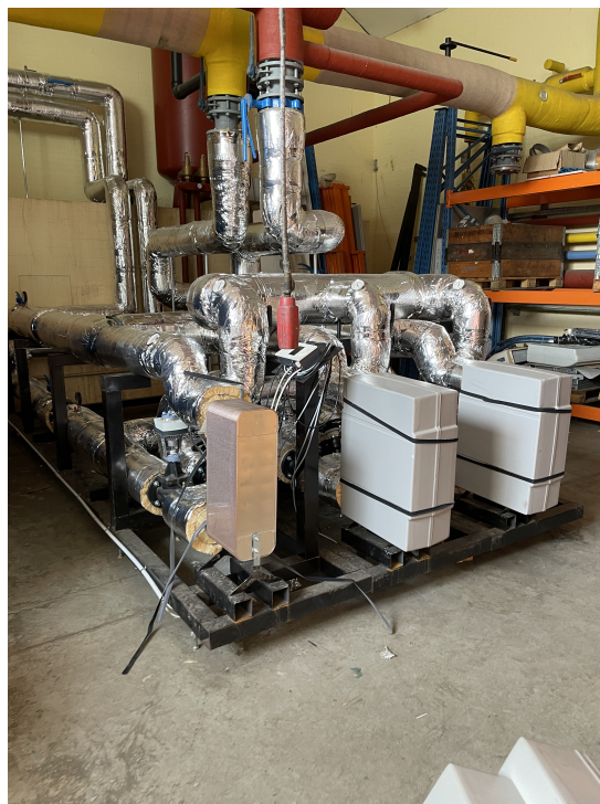
Figur 2.9. Billede af de 3 pladevarmevekslere i varmecentralen
