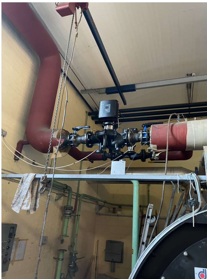
Figur 5.6. Primære cirkuleringspumper med den største pumpe i forgrunden
