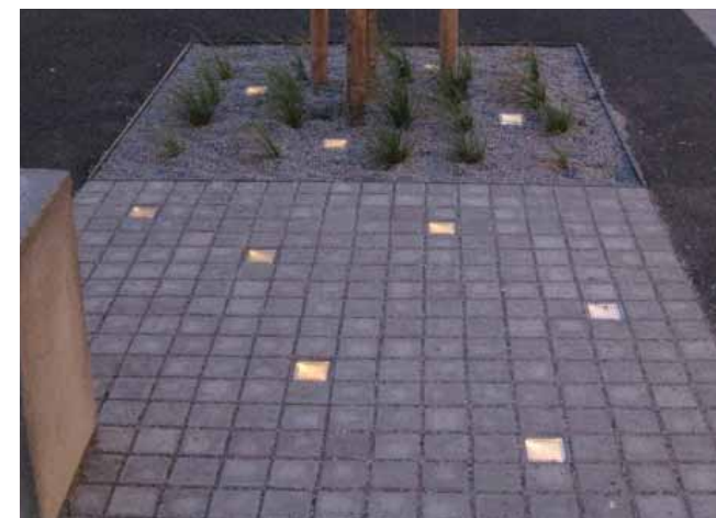
Solcellelys i belægningen.
