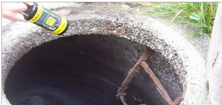
Figur 1. Korroderet kloakbrønd på afskærende ledning i Aalborg Kommune (Vollertsen, 2011)
