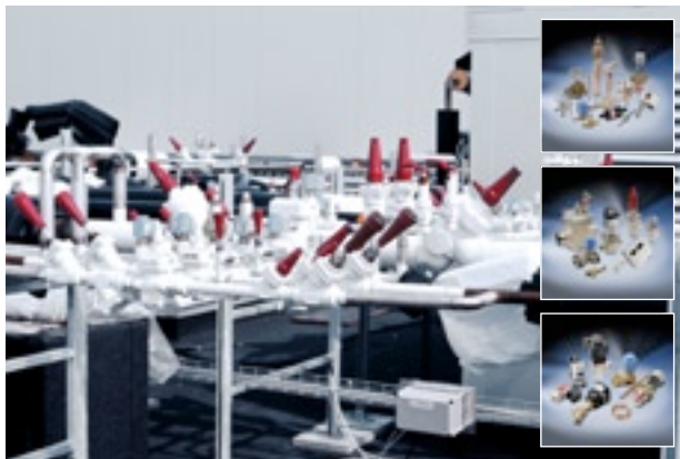
Automatik og ventiler til styring og overvågning af industrielle køleanlæg.
