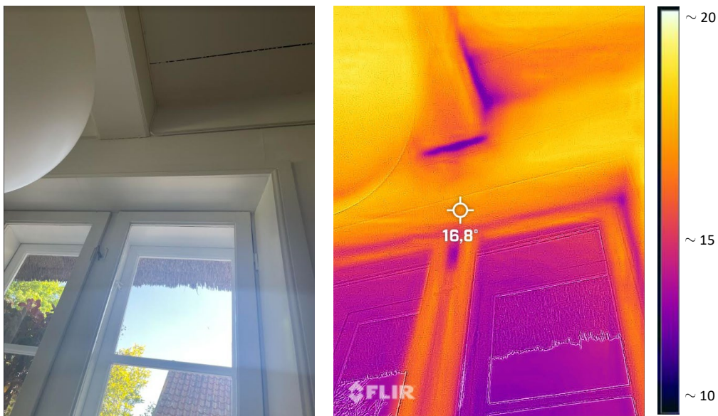
Figur 56: Et almindeligt billede, t.v. og et termografisk billede, t.h. Termograferinger ved undertrykdelen af blower door test på en kold dag afslører utætheder, her ved bjælkeenden.
