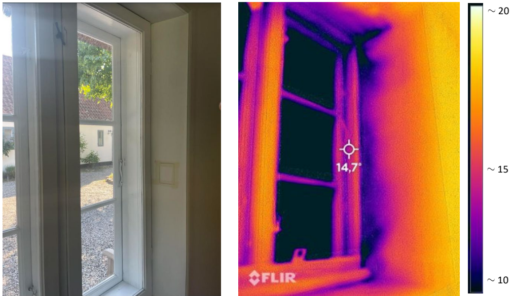
Figur 55: Et almindeligt billede, t.v. og et termografisk, t.h. Termograferinger ved undertrykdelen af blower door test på en kold dag afslører utætheder. Utætheder mellem forsatsruden og -rammen og evt. mellem forsatsrammen og lysningen blev synlige her.
