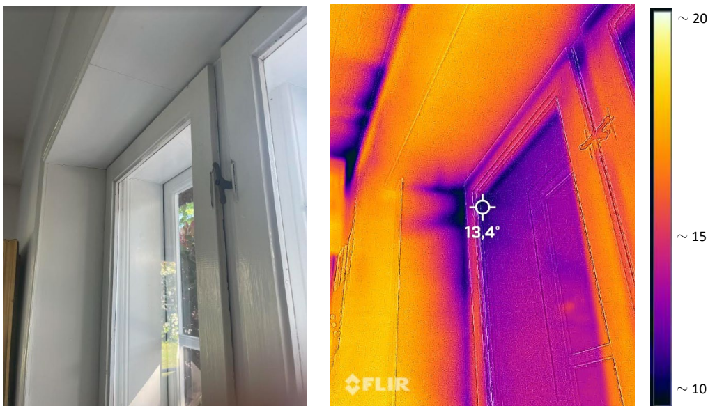
Figur 54: Et almindeligt billede, t.v. og et termografisk billede, t.h. Termograferinger ved undertrykdelen af blower door test på en kold dag afslører utætheder. Utætheder mellem forsatsruden og -rammen og evt. mellem forsatsrammen og lysningen blev synlige her.
