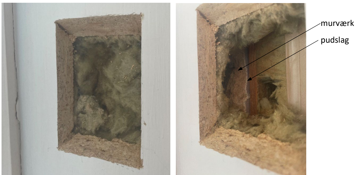
Figur 47: Hullet i lysningen hvor man kan se mineraluld, t.v., og murværk med forsatsvæg, t.h.
