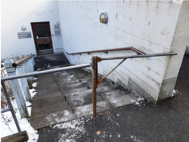
Figur B.8. Gelænder og spærring ved trappe udenfor.
