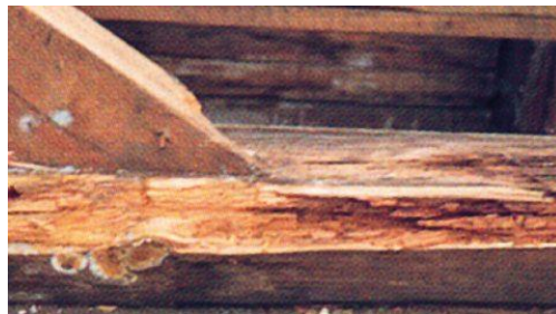
Figur 13. Resultat af trænedbrydende svampe i en tagkonstruktion ( (17) BYG-ERFA (99)141213).
