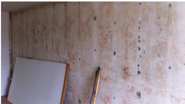
Figur 15. En overflade der er angrebet af skimmelvækst ( (20) BYG-ERFA (31)151115).
