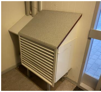
Figur 19. I alle garderober er der monteret en varmeblade i facaden kombineret med luftindtag til erstatningsluft.
