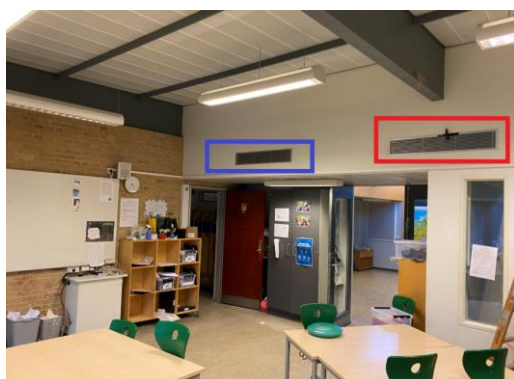
Figur 16. Billedet viser de to af de tre bevarede ventilationsarmaturer i klasselokalet, der er indbygget i et lukket loftskørt. Indblæsningsarmaturet er vist med blå ramme og udsugningsarmaturet er vist med rød ramme.
