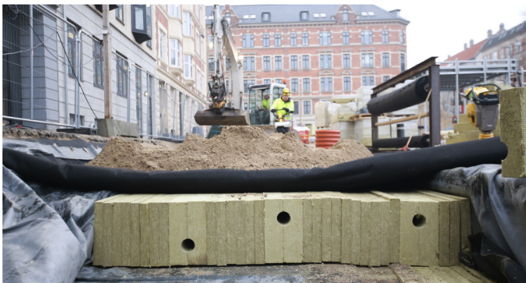
Figur 2.10: Billede af renseteknologi ved brug af stenuldsfaskiner. Kilde: [Hoang, 2019].
