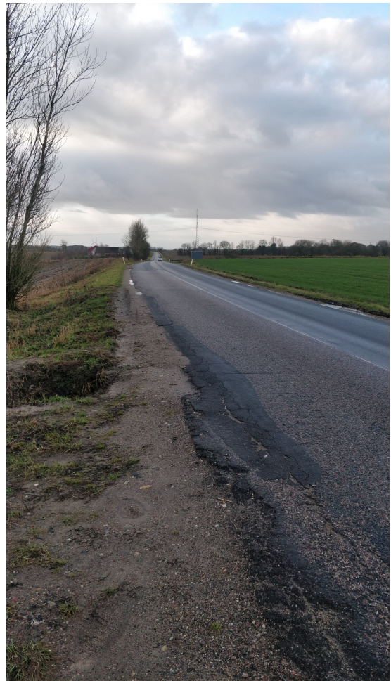
Figur 3.3. Udsnit af Gislumvejs belægning, hvor der ses revner i asfalten ved kørebane kanten.
