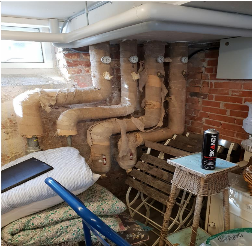
Figur 22 - Distributionsledninger mellem boligblokkene i jorden og igennem boligblokkene
