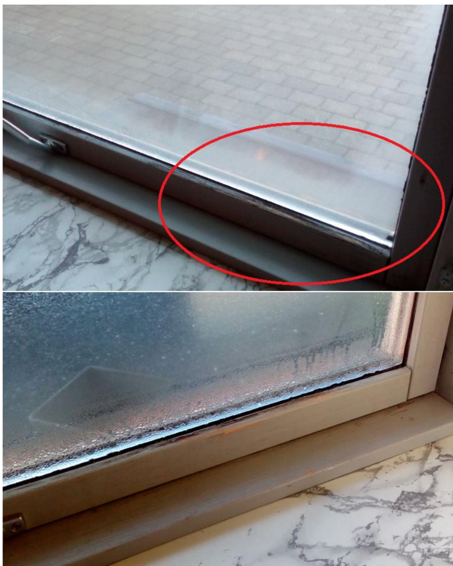
Figur 13 Kondens på vindue i soveværelse, eget foto
