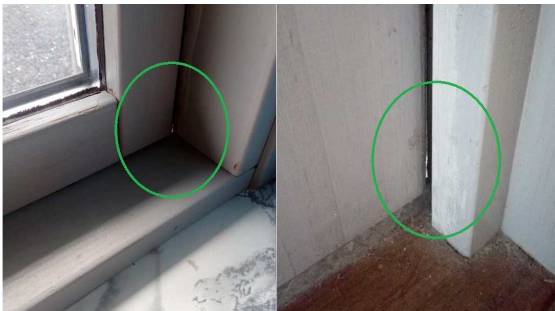
Figur 11 Manglende tætning ved værelsesvindue (tv) og tilsvarende ved bund af terrassedør i køkken (th), eget foto
