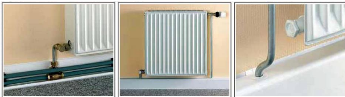
Figur 19 Foto af installation med rørpanelløsning fra Gabotherm. Kilde: ( https://www.kierulff.dk )
