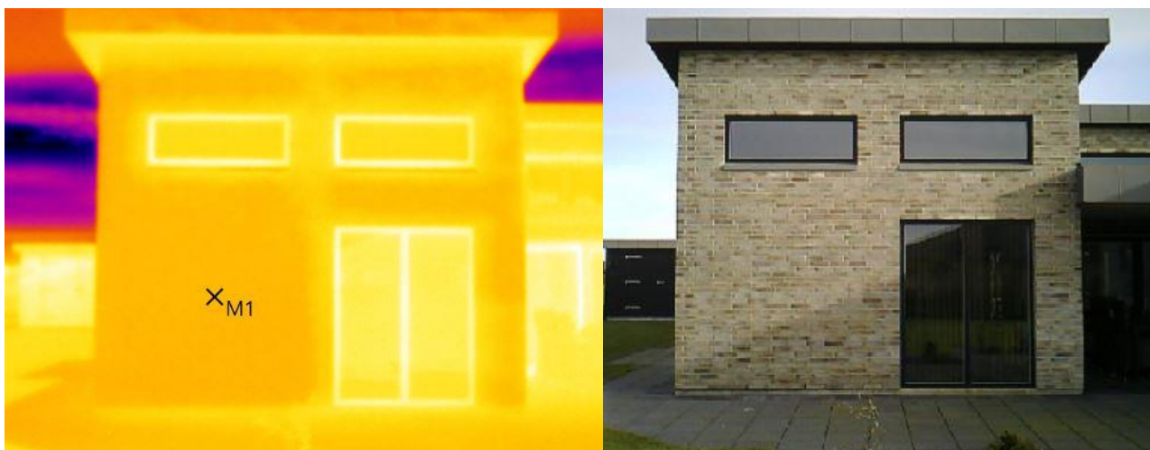
Billede 27 - Termografi af udvendig side af ydervæg med indbygget HEB120 profil (tv) samt tilhørende realbillede af ydervæggen (th). M1=-4,6°C.
