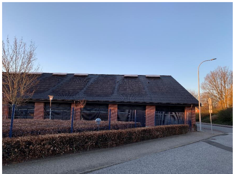
Billede 1 - Eksempel på synlige aftegninger af indbyggede kuldebroer i en tagkonstruktion. Aftegningerne fremstår med områder uden rimfrost på tagbeklædningen.
