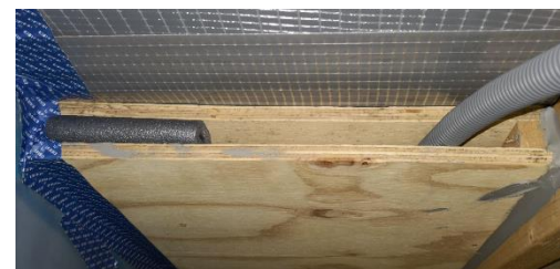
Figur 36: Ventilationsspalten er her blokeret med 1/3 rørisolering.
