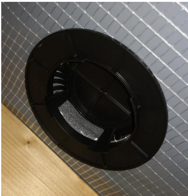
Figur 40: Ventilationsstuds af typen Icopal IcoAir, tilstoppet med rørskål i den ene side. Placeringen af rørisoleringen blev delt således at den 1/3 eller de 2/3 blev ligeligt fordelt i begge sider – og areal over og under var større eller mindre – men åbent begge steder.
