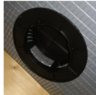
Figur 23 Icopal IcoAir. Ventilationsstudsens er vist med delvist blokeret ventilationsareal.
