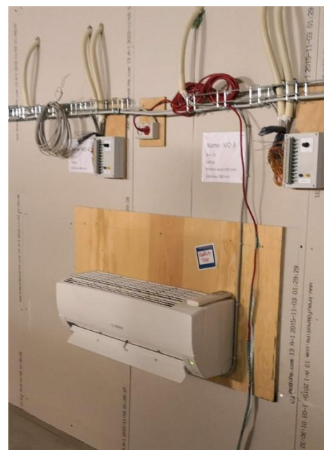
Figur 19 Varmepumpen er monteret på væggen, hvor også målerbokse til træfugtmålere (for hver tagrum) er placeret.
