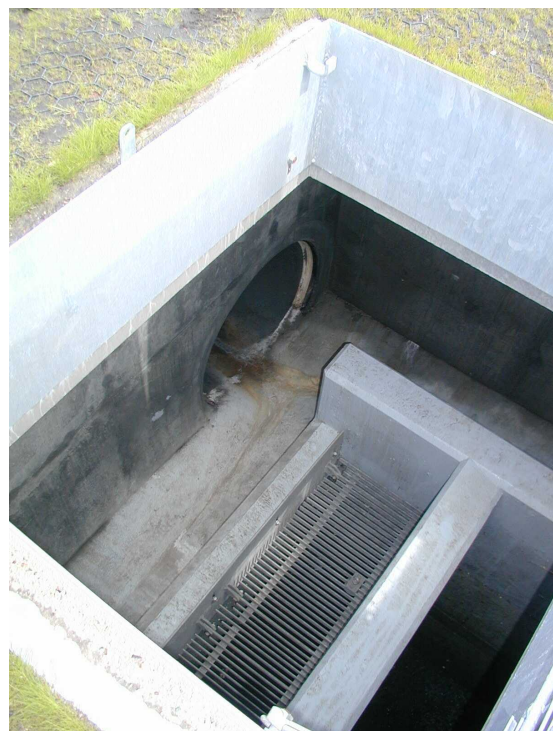
Figur 7.7: Overløbet i Grindsted ved Energivej 12. [Aalborg Kloak A/S]
