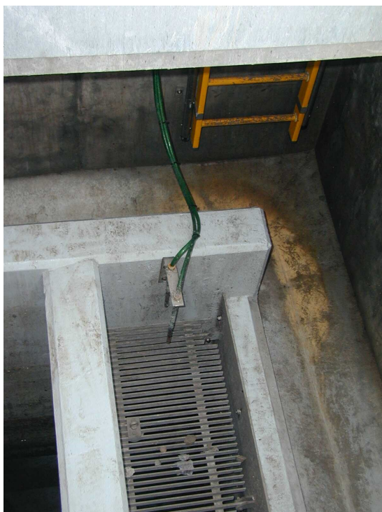
Figur 7.6: Overløbet i Grindsted ved Energivej 12. [Aalborg Kloak A/S]
