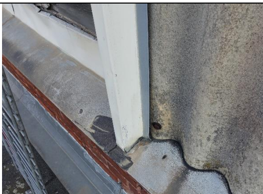
Billede 19: Facade mod Vest: Zinkindækninger og sålbænke er flere steder udført byggeteknisk forkert og der er opstået kraftige revnedannelser lodningerne. Skaderne er uden held forsøgt udbedret med en udefinerbar fugemasse.
