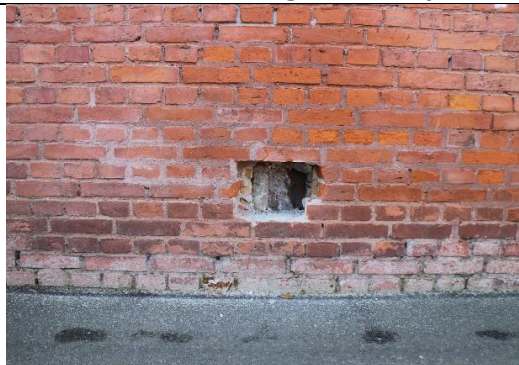
Billede 23: Facade mod Øst: Destruktiv prøve ved bærende stålsøjle indmuret i væg. Tydelige tegn på opfugtning af facaden.
