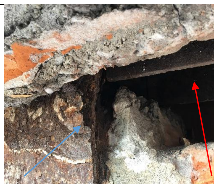
Billede 26: Facade mod Vest: Destruktiv prøve omkring samlingen af stålsøjle (blå pil) og -bjælke(Rød pil). Begge med kraftig rustdannelse.
