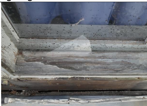
Billede 17: Facade mod Vest: Sålbænk er her ikke længere mekanisk fastgjort til bindingsværket, hvilket medføre at slagregn, der rammer vinduespartiet, afvandes direkte ned i konstruktionen, samt opfugter stålbjælken der begynder at ruste.
