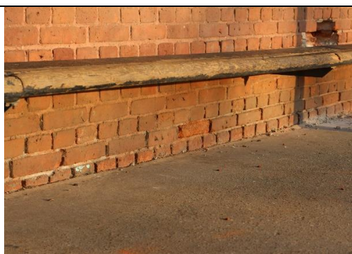
Billede 14: Facade mod Vest: På Vestvendt facade kan der registreres udvaskning af fuger, selvom facaden er overdækket af halvtaget. Terrænet med asfalt er ført direkte op til den opmurede facade. Enkelte steder kan der registreres afskallede mursten.
