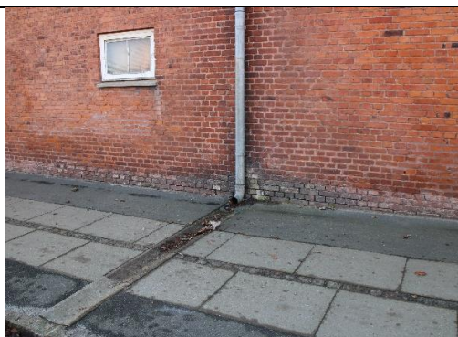
Billede 4: Facade mod Øst: Tagnedløb i skellet mellem gymnastiksal og omklædning utæt og årsag til kraftig lokal opfugtning af opmuret facade. Afledning af vand vurderes ineffektiv, da denne afledes direkte til overfladen af terræn og ikke direkte ned i kloak.
