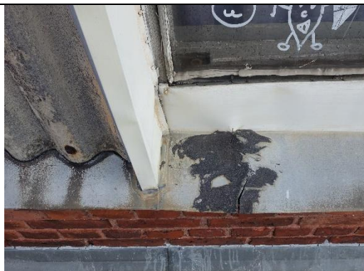
Billede 18: Facade mod Vest: Kraftig revnedannelse i zinksålbænk under vindusparti i bindingsværket.
