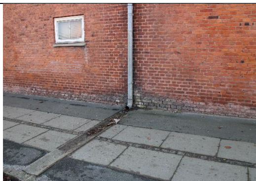
Billede 9: Facade mod Øst: Tagnedløb i skellet mellem gymnastiksal og omklædning utæt og årsag til kraftig lokal opfugtning af opmuret facade. Afledning af vand vurderes ineffektiv, da denne afledes direkte til overfladen af terræn og ikke direkte ned i kloak.
