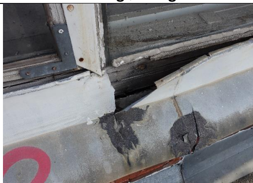
Billede 16: Facade mod Vest: Kraftig revnedannelse i zinksålbænk under vindusparti i bindingsværket. Her ses hvordan sålbænken er tænkt ført ind under glaspartiet, og forsøgt fastholdt med vindueslisterne.
