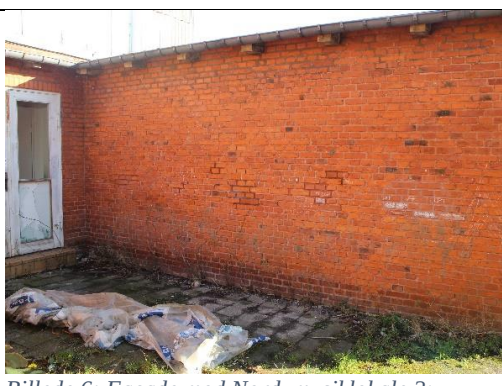
Billede 6: Facade mod Nord, musiklokale 2: Tydelige tegn på opfugtning af facade. Misfarvninger og krystalisering af salte på overfladen. Både flisebelægning og jord er ført direkte op til facaden.
