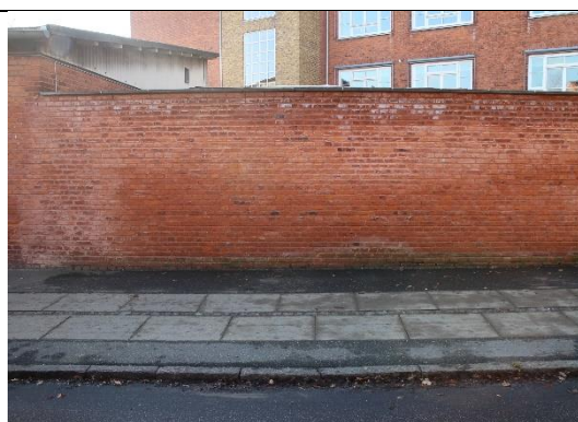
Billede 5: Facade mod Øst: Kold læmur viser tydelige tegn på opfugtning som mørke skjolder på facadens overfalde.
