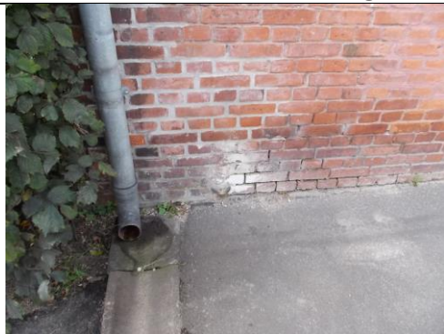
Billede 11: Facade mod Øst: Udvaskningen af fuger på den Øst vendte facade er meget dybe og er et generelt forekommende problem på facaden.
