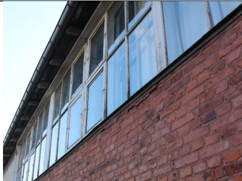
Billede 21: Facade mod Øst: Vandret revnedannelse i skellet mellem opmuret facade og bindingsværk, pga. rustdannelse på vandret stålbjælke.
