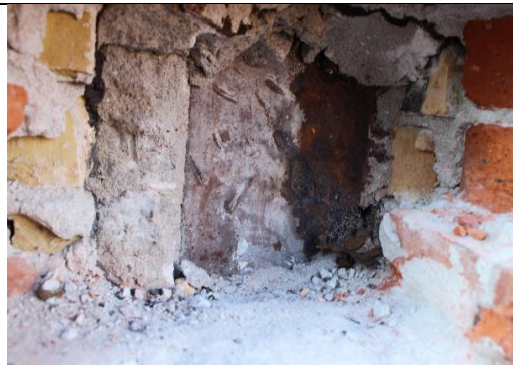
Billede 24: Facade mod Øst: Destruktiv prøve ved bærende stålsøjle indmuret i facaden. Kraftig rustdannelse og delaminering af stål
