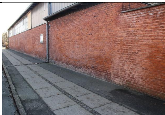
Billede 3: Facade mod Øst: Tydelige tegn på opfugtning af facade i skellet mellem gymnastiksal og omklædning. Misfarvninger og krystalisering af salte på overfladen af tegl.
