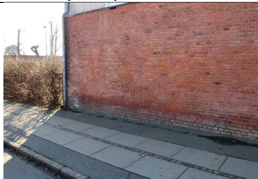
Billede 1: Facade mod Øst: Tydelige tegn på opfugtning af facade. Misfarvninger og krystalisering af salte på overfladen af tegl.
