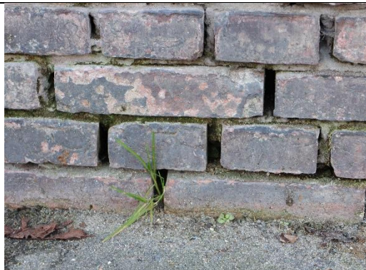
Billede 8: Facade mod Øst: Udvaskningen af fuger på den Øst vendte facade er meget dybe og er et generelt forekommende problem på facaden.
