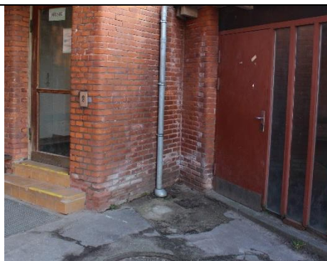
Billede 10: Facade mod Vest: Tydelige tegn på opfugtning af facade. Misfarvninger og krystalisering af salte på overfladen af tegl i mødet mellem facade på gymnastiksal og toiletbygning.
