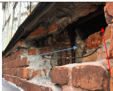
Billede 25: Facade mod Vest: Destruktiv prøve omkring samlingen af stålsøjle (blå pil) og -bjælke(Rød pil). Begge med kraftig rustdannelse.
