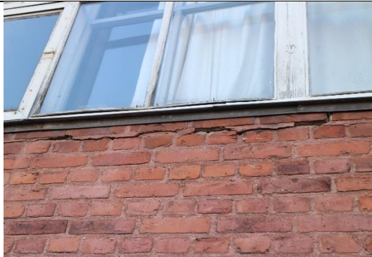
Billede 22: Facade mod Øst: Vandret revnedannelse i skellet mellem opmuret facade og bindingsværk, pga. rustdannelse på vandret stålbjælke.
