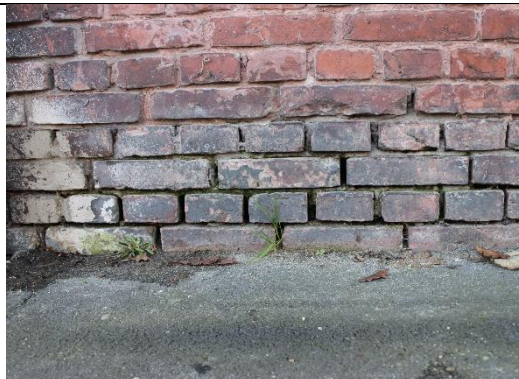
Billede 7: Facade mod Øst: Misfarvninger og krystalisering af salte på overfladen af tegl. Udvaskning af fuger er specielt kraftig i de fem nederste skifter over terræn. Afskalling på overfalden af mursten ses også hyppigt i dette område.
