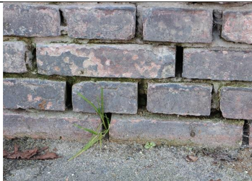
Billede 12: Facade mod Øst: Udvaskningen af fuger på den Øst vendte facade er meget dybe og er et generelt forekommende problem på facaden.
