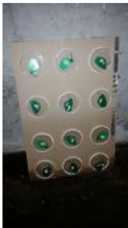
Figur 29. Opfugtning af gipsplade i kælder.
