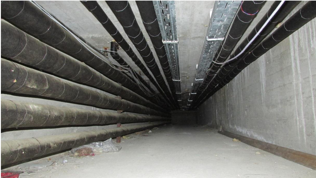
Figur 5. Fremføring af installationer i bygningens ingeniørgang.
