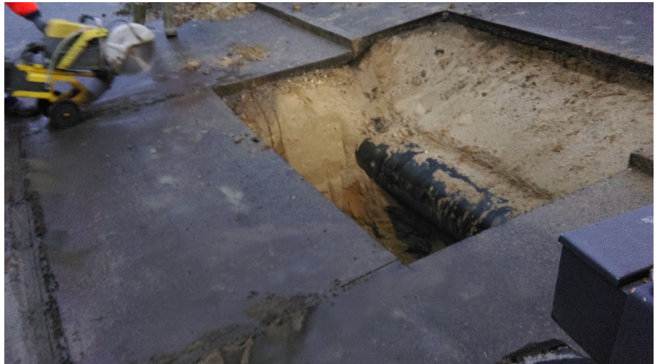
Figur 11: Fejl opstået i den horisontal kommunikation og hullet skal åbnes yderligere for at finde fejlen. Det er ikke den eneste udvidelse den sammenfaldende grænse, hullet er.
