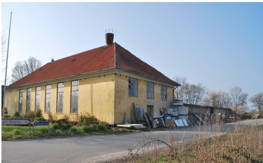
Forfalden bygning i Lolland Kommune
