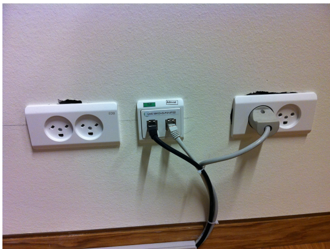
Figur 9.1. Eksempel fra Musikkens Hus på svigt ved elafslutning ved gipsvæg.
