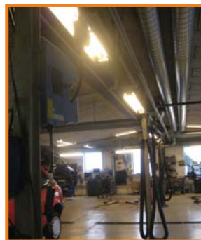
Ill. 4: Loftslamperne giver ikke den rette belysning når der arbejdes under bilerne.
