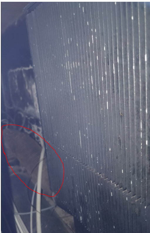
Figur 1.1: Radiator med tilhørende indblæsningsrør, markeret med rødt.
