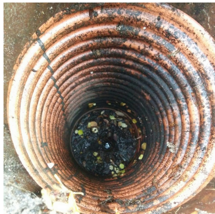
Figur D.4: Brønd 3.8 uden vandspejl.
