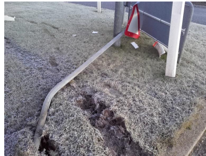
Figur C.1: Skade på vigepligtsskilt.
