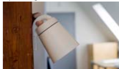
Ill. 6.15: Vinklen er lidt for stor mellem lampen og stolpen.
